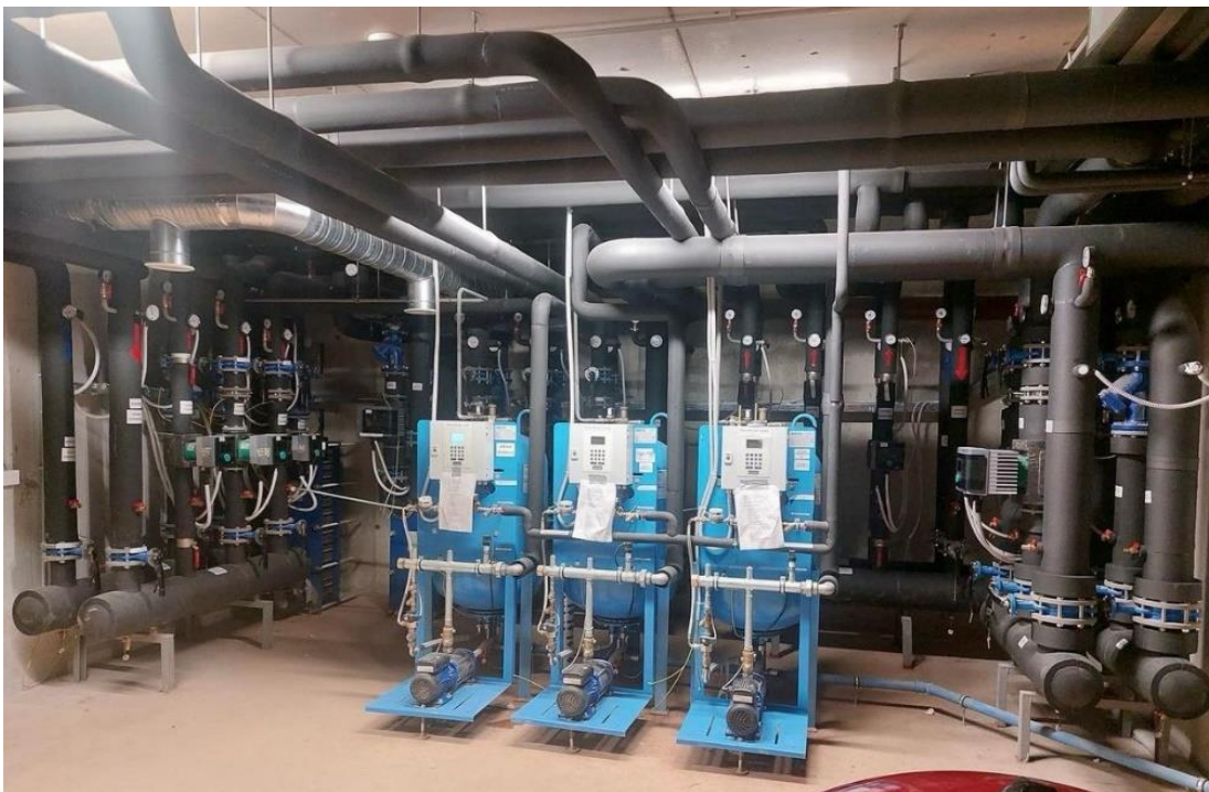
Kotlovnica večstanovanjskega objekta
