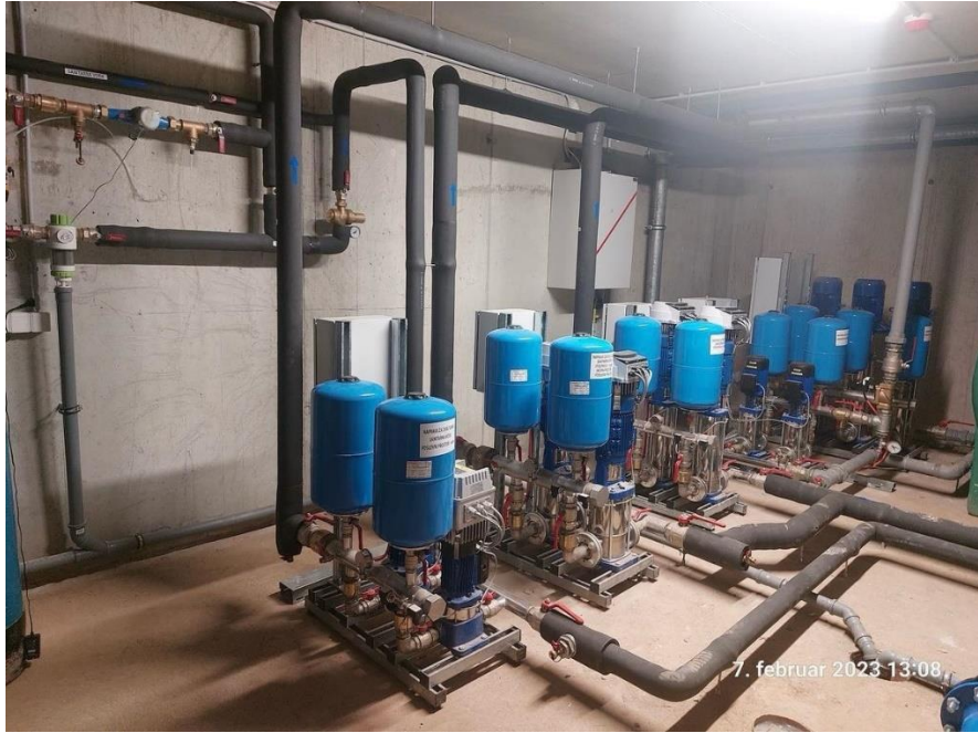
Slika 1 Slika kotlovnice 2[Lasten vir]
