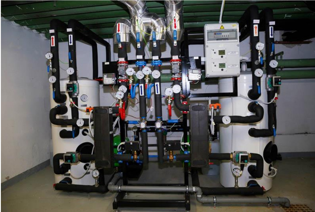
Toplotna postaja večstanovanjskega objekta
